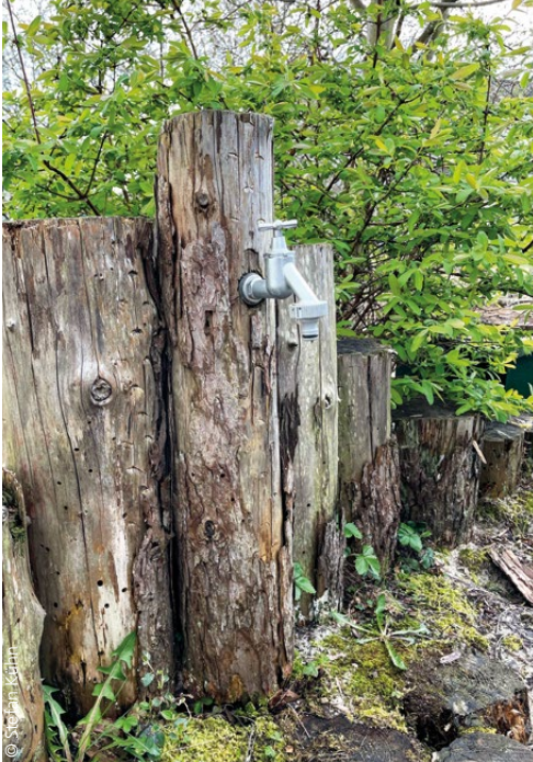
Der Wasserhahn einer Zisterne lässt sich gut in den natürlichen Garten integrieren.
