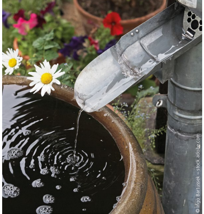
Mit einem sogenannten Regendieb kann man das Regenwasser aus einem Fallrohr entnehmen und in einer Regentonne sammeln.
